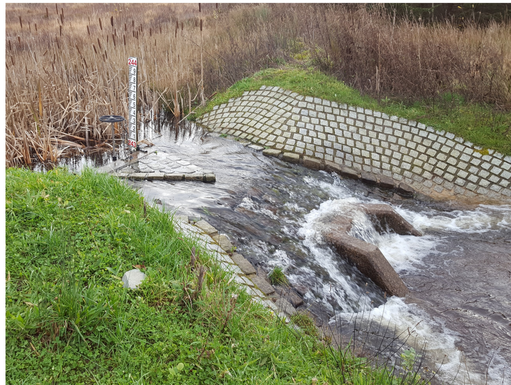
Gorlif presennol y gronfa ddŵr, i'w symud oddi yno Existing reservoir overflow, to be removed
